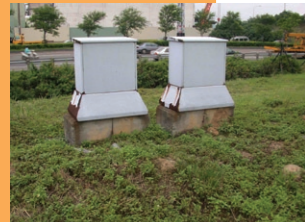
變電箱旁的蟻丘
